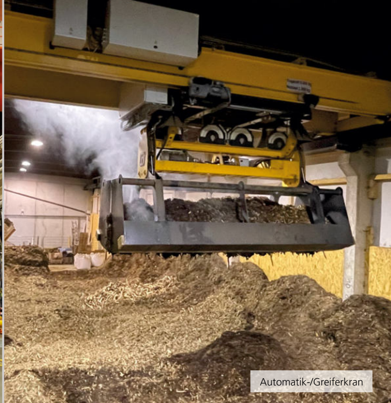
125 t Doppel-Kranbrücke mit Hebezeug
